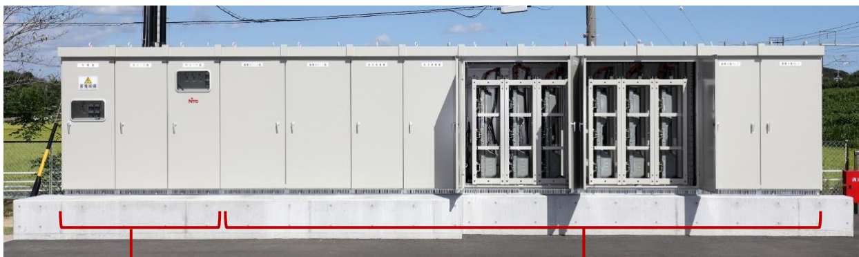
高圧受電設備
