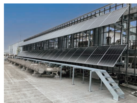
府中ビル 太陽光パネル
