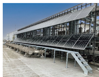
府中ビル 太陽光パネル
