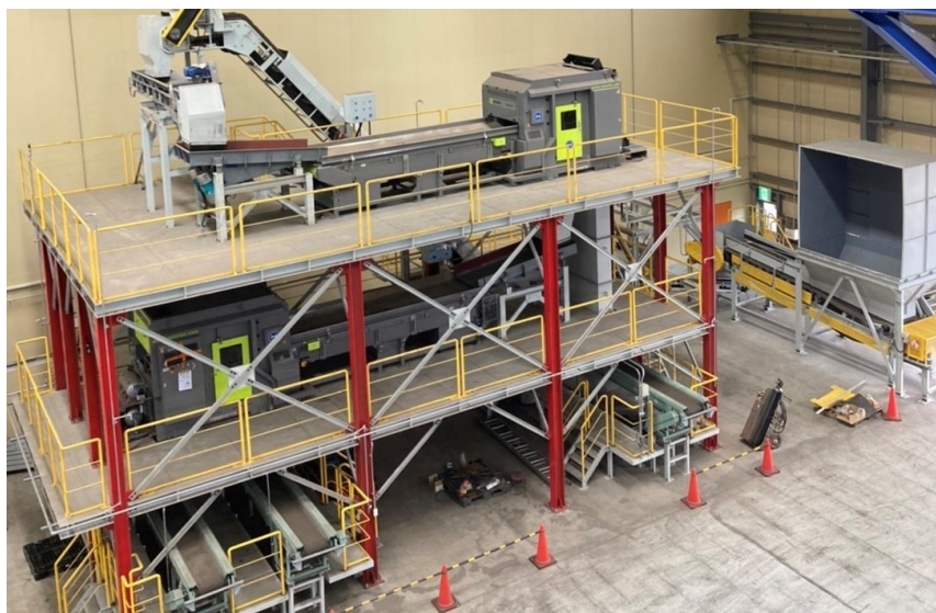
(エコネコル富士工場に設置した選別機)
