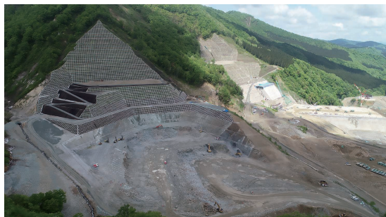
成瀬ダム原石山採取工事(第1期) (秋田県雄勝郡) 発注者:国土交通省 東北地方整備局
