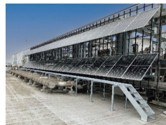
府中ビル 太陽光パネル
